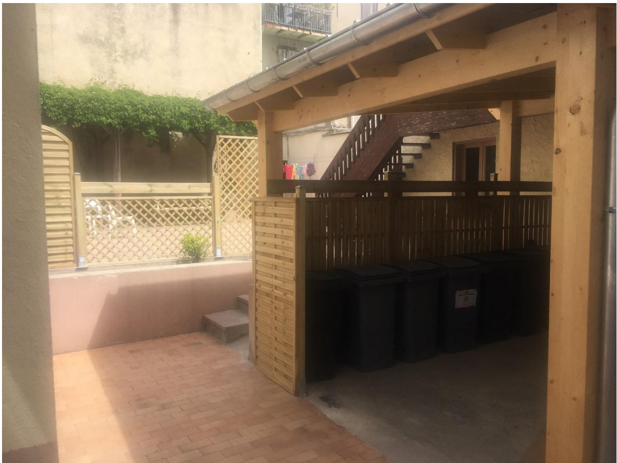
Cour du CADA Vernoux rénovée en 2022 avec création d'une dalle en béton, d'un abri à poubelles en dur, de barrières de sécurité sur la partie terrasse.
